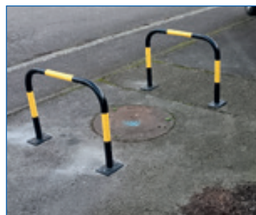
➔ Quartier Eglise : Installation d'un garde-corps autour de la réserve incendie par la régie.
